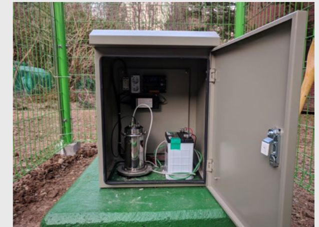
▲ Seismometer Platform (Mar 2019) Seismometerplattform (März 2019)
